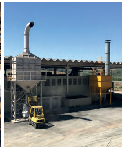
Sistema de despoejamento
