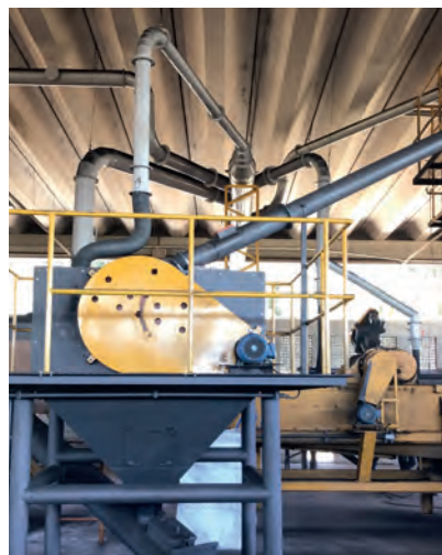
Britagem e rebritagem de carvão antracito
